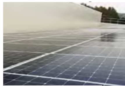
Dettaglio pannelli solari copertura Superstudio Maxi.
